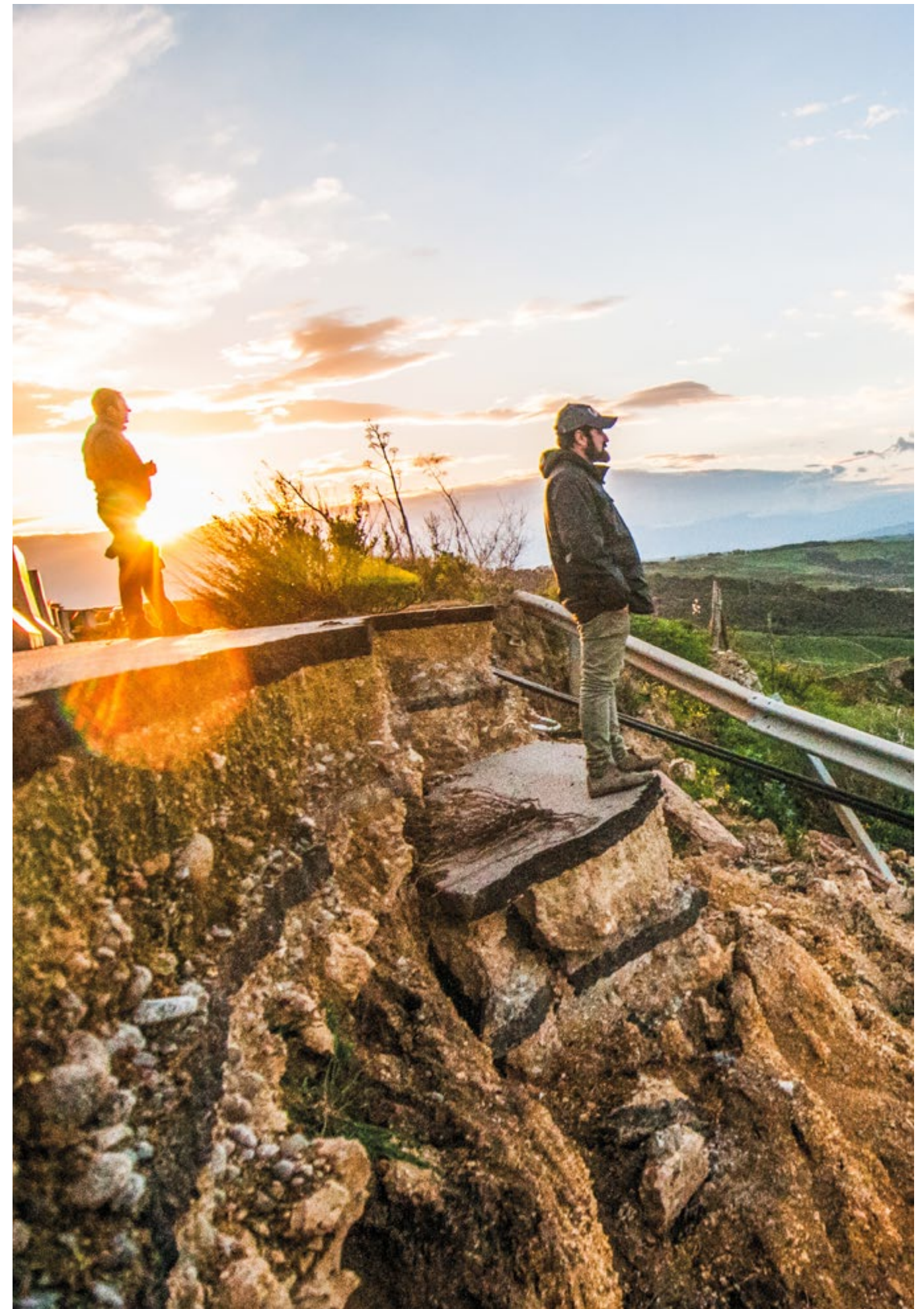
Crollo di strada a causa di forti precipitazioni a Crotone | 2022 - SIMONE PADOVANI
