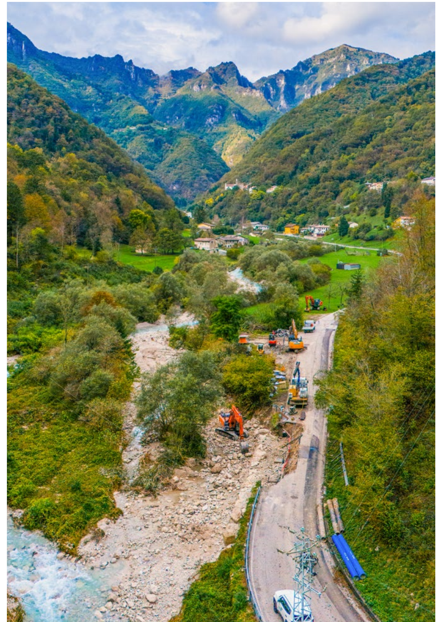
Le forti alluvioni del settembre 2024 nel comune Setteville di Belluno hanno causato il cedimento delle linee elettriche, dei tubi idrici e stradali isolando gli abitanti | 2024 - SIMONE PADOVANI
